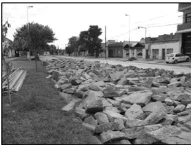
Figura 7. Residuos de repavimentación. Calle Jujuy altura 1200. S. M. de Tucumán
