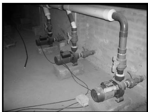
Figura 3. Sistema de bombeo.
