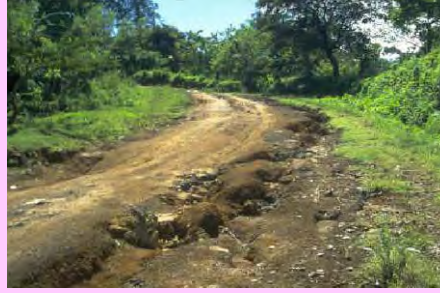
Foto C24: camino con drenaje inadecuado
