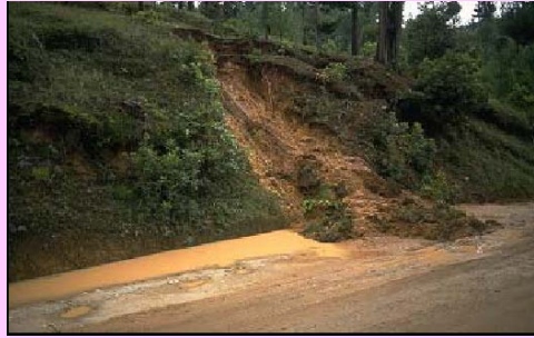
Foto C27: Cuneta bloqueada por erosión
