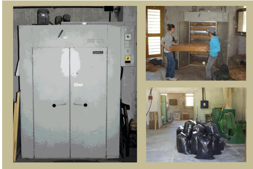
Figura N° 11: Imágenes del Secadero de virutas HEREAUS, de las virutas secadas y de las virutas embolsadas. Fuente: Dr. Ing. J. C. Medina.
